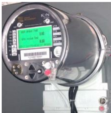
Рисунок 1. Внешний вид счётчиков электроэнергии многофункциональные ION 8300
